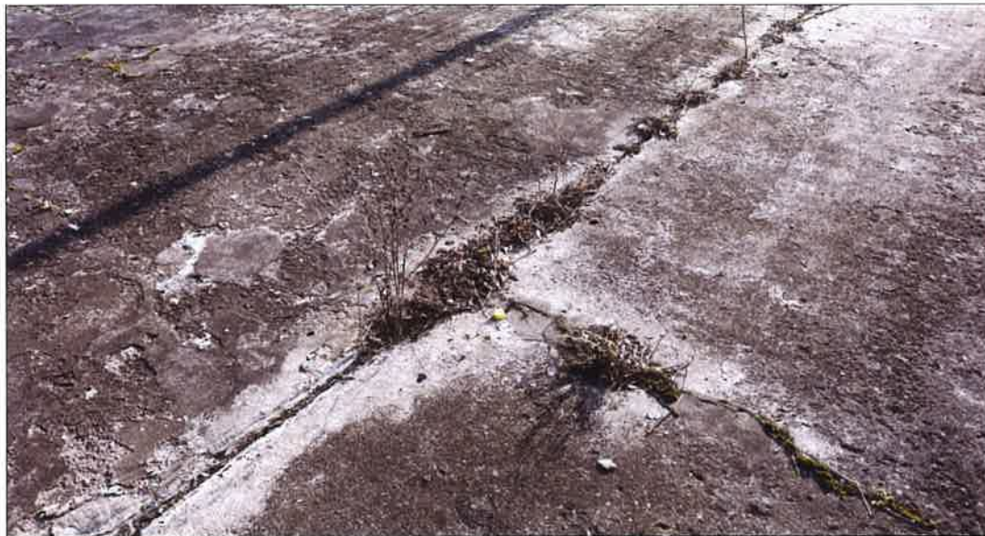
Dylatacje w betonowej powierzchni toru jezdni z widocznymi przerostami roślinności oraz odspojeniami wierzchniej powłoki betonowej. (fot. Jakub Andrzejewski, 2020 r.)
