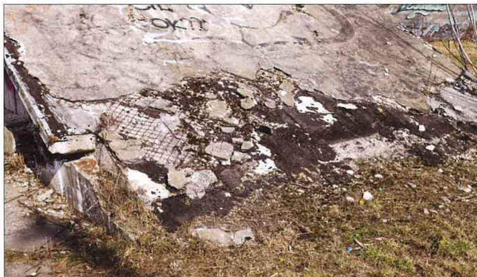
Zadaszenie przejścia podziemnego na połączeniu z gruntem, widoczne odspojenia wierzchniej warstwy cementowej ułożonej na siatce. (fot. Jakub Andrzejewski, 2020 r.)
