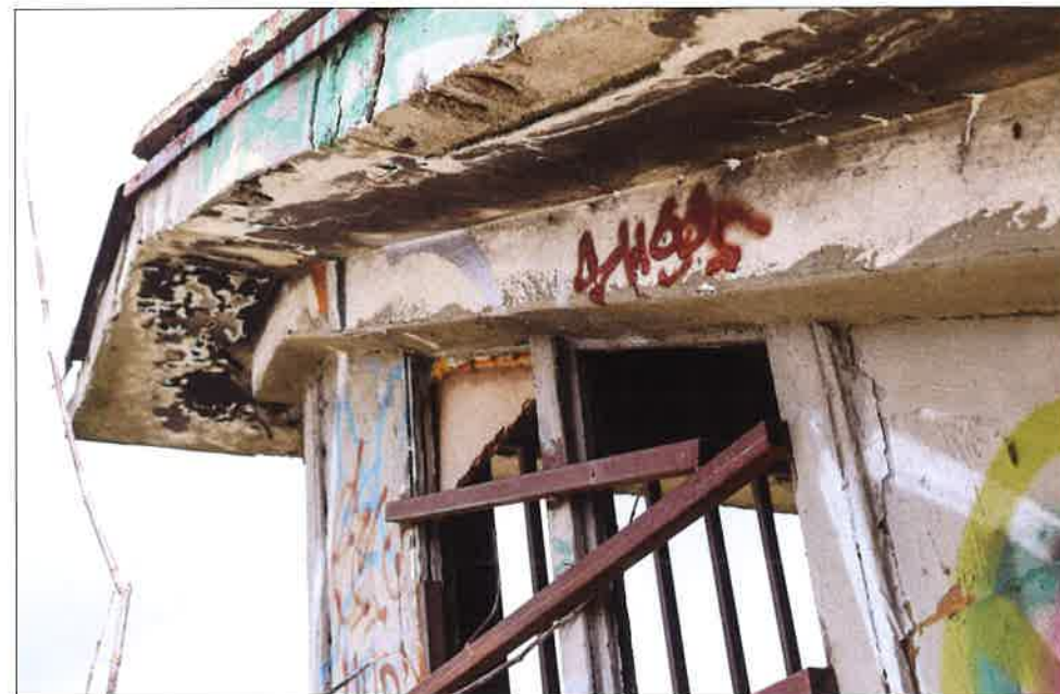
Oryginalne otwory okienne doświetlające zejście do przejścia podziemnego, z usuniętym szkleniem, wtórnie zaślepione. (fot. Jakub Andrzejewski, 2020 r.)
