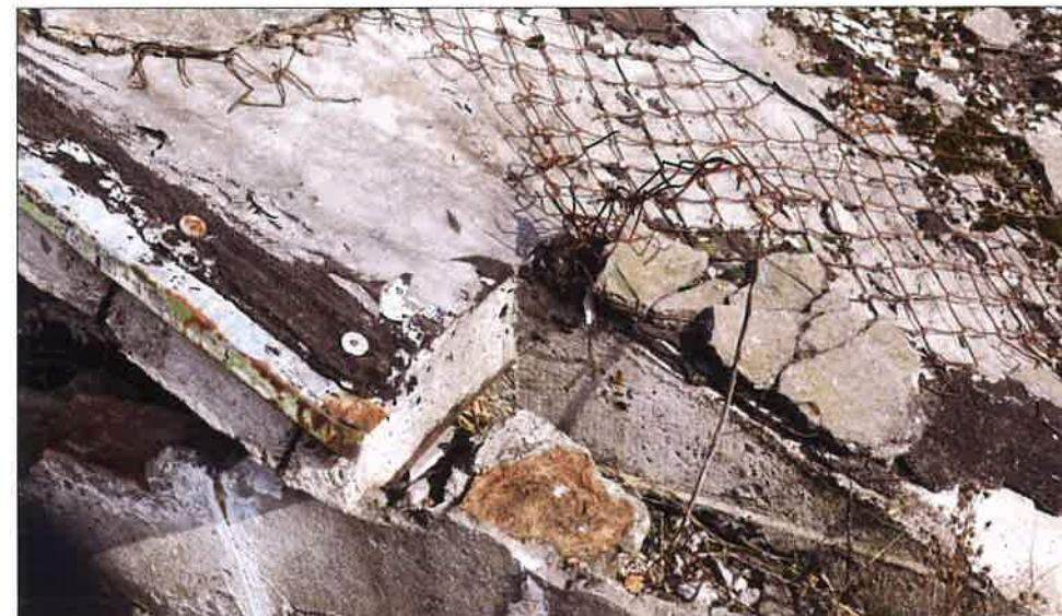
Warstwy zadaszenia nad przejściem podziemnym. Wierzchnia warstwa cementowa ułożona na siatce i warstwie papy. (fot. Jakub Andrzejewski, 2020 r.)
