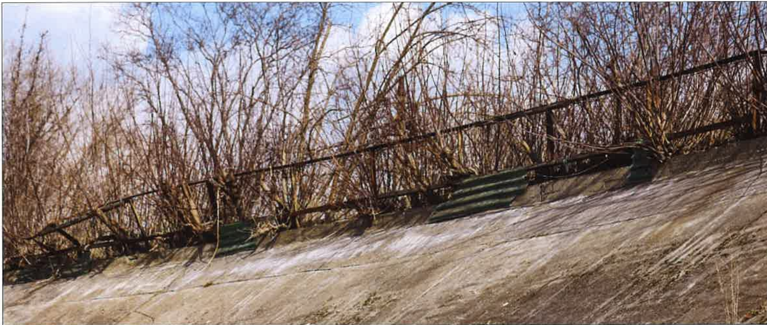
Barierki odgradzające tor jezdny od trybun po stronie północno-wschodniej, widoczne rosnące samorzutnie drzewa samosiejki w miejscu trybun i zniszczonych ławek. (fot. Jakub Andrzejewski, 2020 r.)
