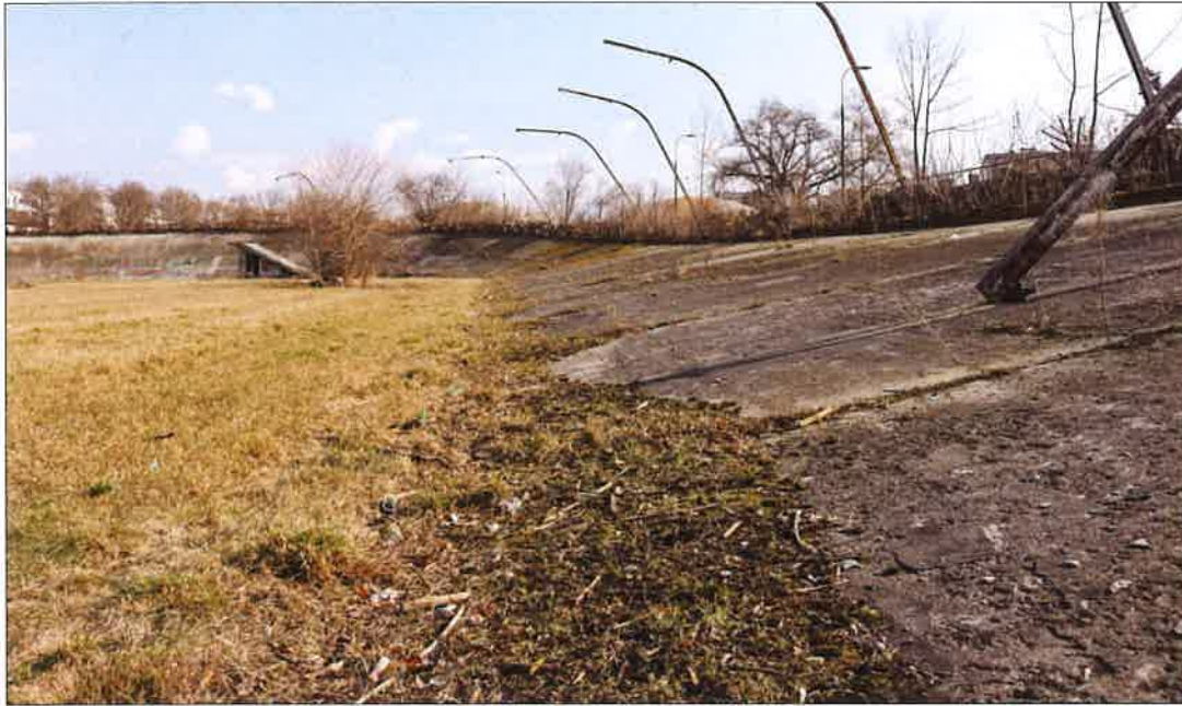
Zaniedbana dolna część betonowego toru jezdni, widoczne uszkodzenia powierzchni betonowej. (fot. Jakub Andrzejewski, 2020 r.)
