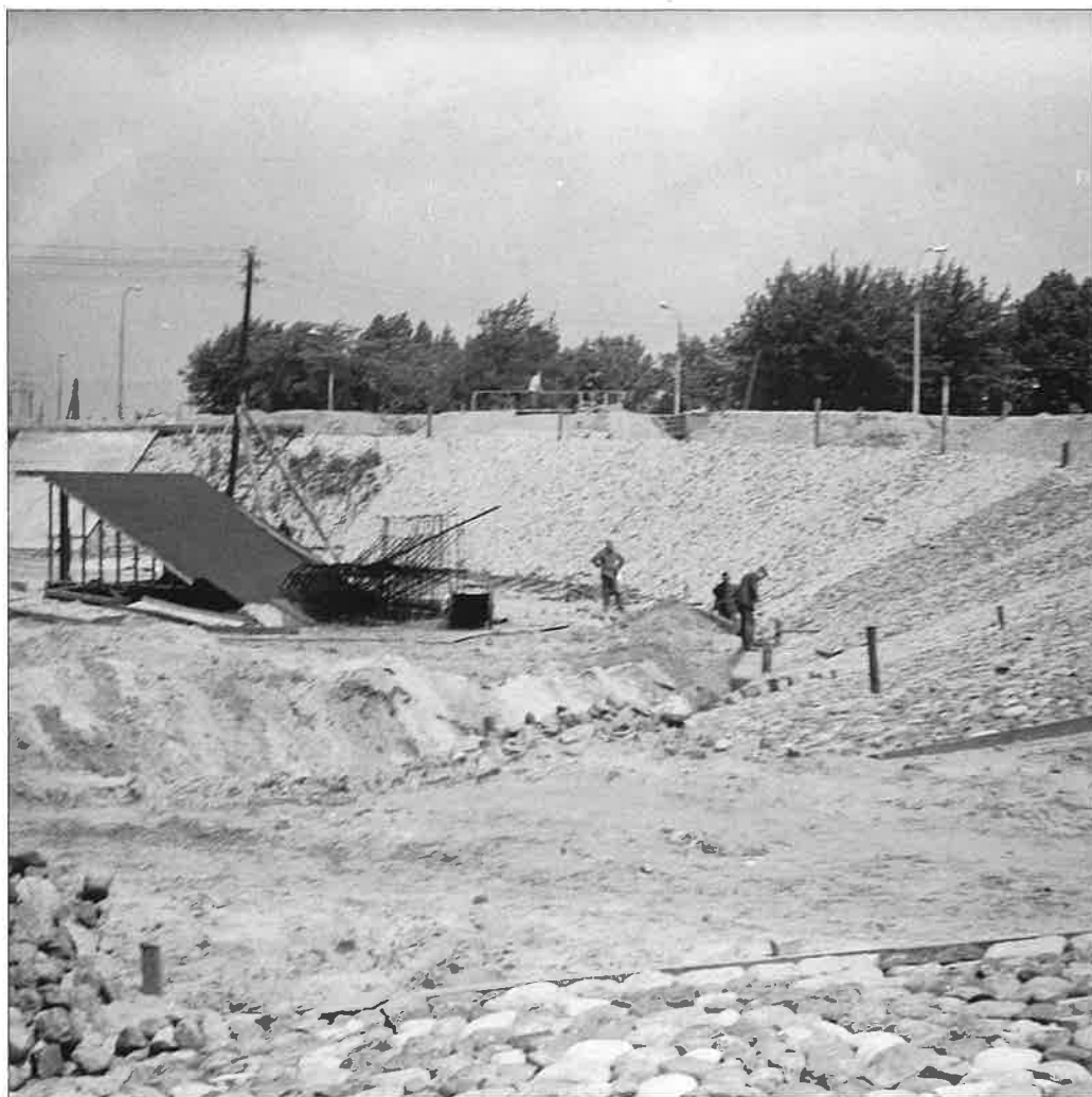
Budowa welodromu w latach 1970-1972, widoczny bruk z kamieni polnych jako podbudowa dla betonowej powierzchni toru. (źródło: Narodowe Archiwum Cyfrowe, audiovis.nac.gov.pl; sygn. 40-W-102-5 )
