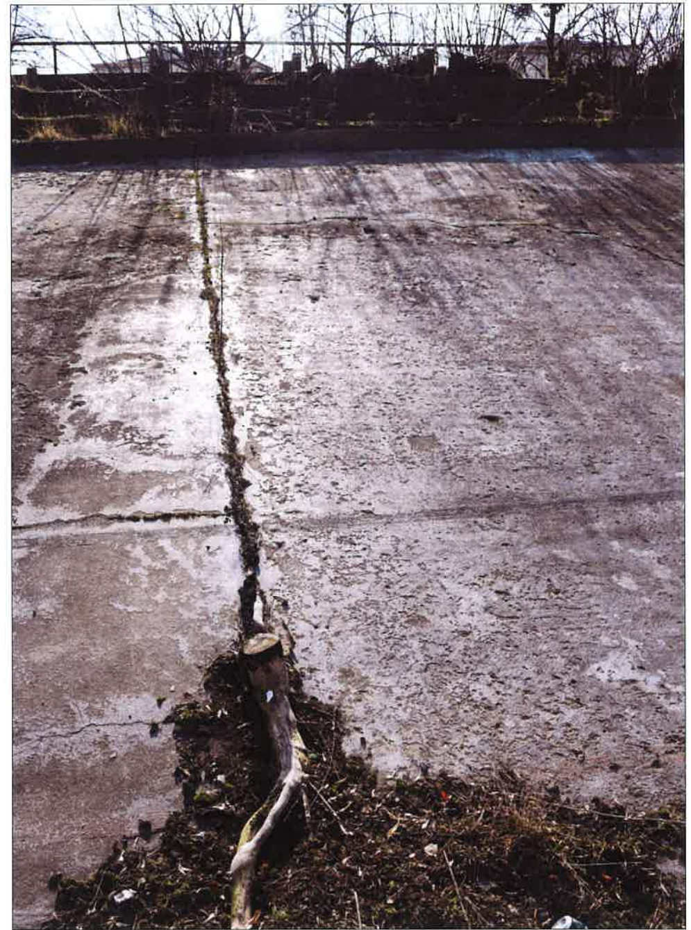
Roślinność w dylatacji pomiędzy kolejnymi fragmentami betonowego toru jezdni (fot. Jakub Andrzejewski, 2020 r.)
