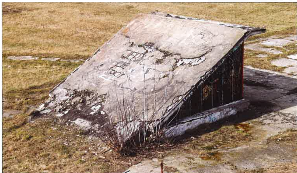
Żelbetowe zadaszenie przejścia podziemnego po wewnętrznej stronie toru, widok od strony wschodniej. (fot. Jakub Andrzejewski, 2020 r.)
