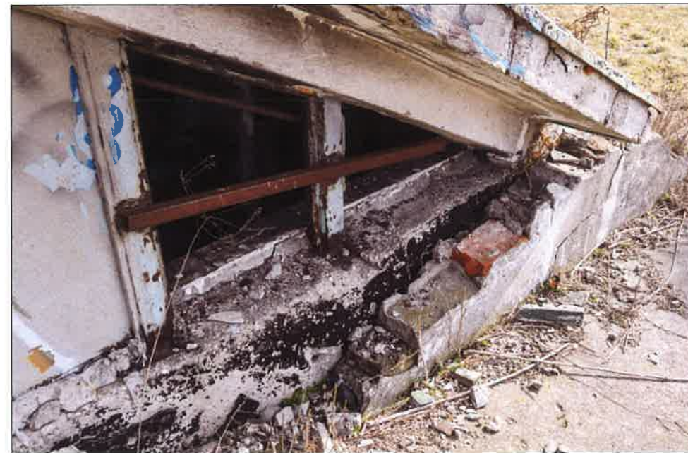
Połączenie żelbetowego zadaszania z podłożem, widoczna odspojona warstwa cegieł od żelbetowej ściany przejścia podziemnego. (fot. Jakub Andrzejewski, 2020 r.)
