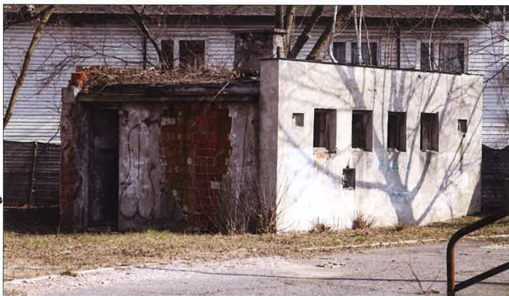
Zaniedbany i zdewastowany budynek zaplecza sanitarnego dla widzów po stronie północno-wschodniej. (fot. Jakub Andrzejewski, 2020 r.)
