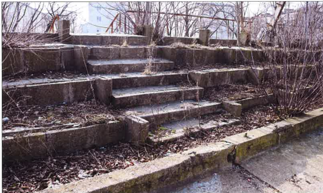
Widok ogólny trybun kierunku południowo-zachodnim z widocznymi zniszczonymi czterema rzędami ławek. (fot. Jakub Andrzejewski, 2020 r.)
