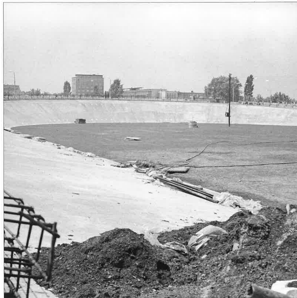
Budowa toru kolarskiego w latach 1970-1972, widoczna wykończona betonowa powierzchnia toru, jeszcze bez zainstalowanych słupów oświetleniowych. (źródło: Narodowe Archiwum Cyfrowe, audiovis.nac.gov.pl ; sygn. 40-W-102-4)
