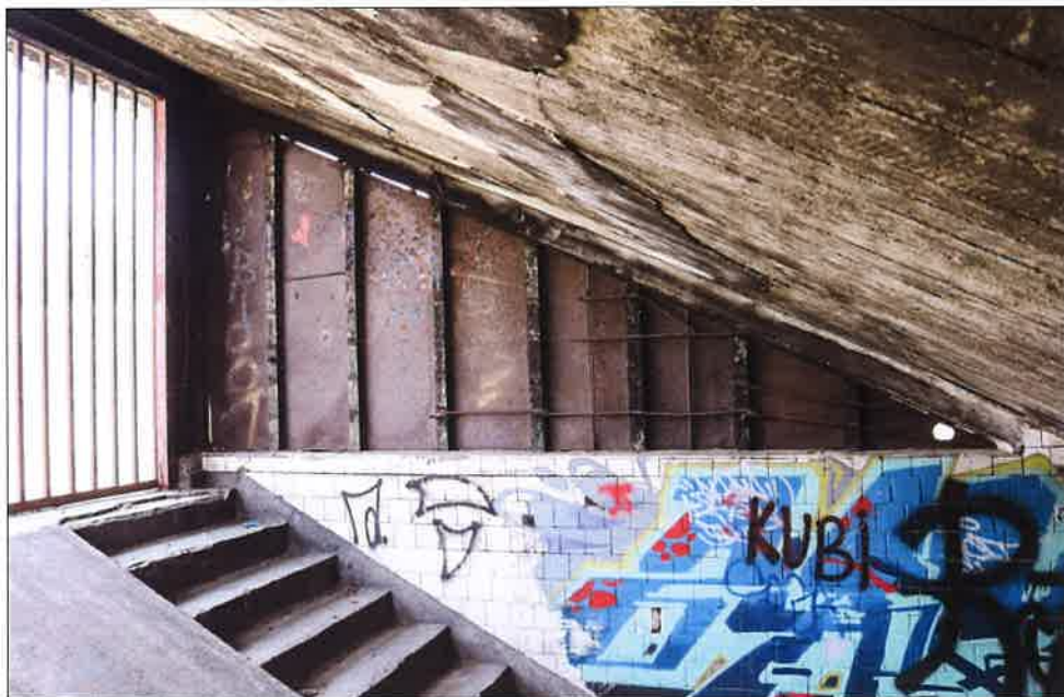
Wnętrze żelbetowego zadaszania i przejścia podziemnego po wewnętrznej stronie toru, widoczne zasłonięte okna doświetlające. (fot. Jakub Andrzejewski, 2020 r.)
