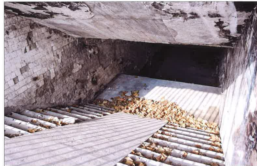
Wejście do przejścia podziemnego po zewnętrznej stronie toru, widoczne zniszczenia ścian spowodowane wilgocią oraz pożarem. (fot. Jakub Andrzejewski, 2020 r.)
