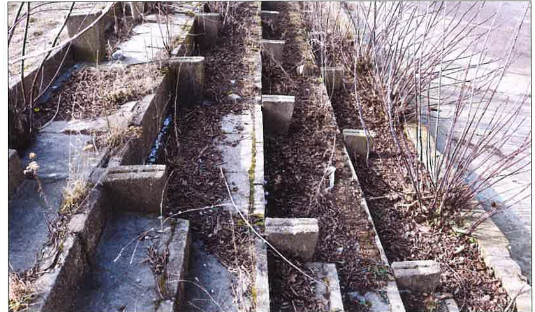
Zniszczone ławki bez drewnianych siedzisk, na trybunach rosną samorzutnie drzewa samosiejki. (fot. Jakub Andrzejewski, 2020 r.)
