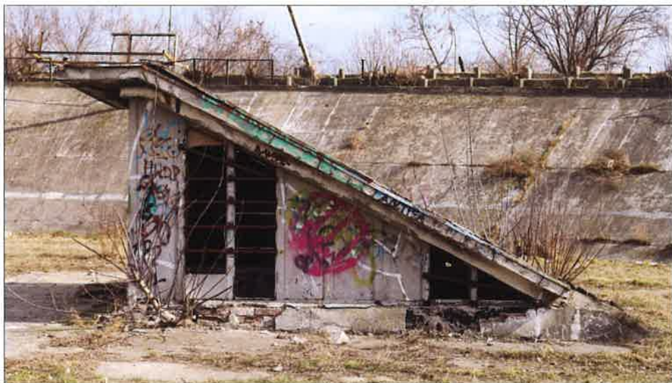
Zadaszenie przejścia podziemnego po wewnętrznej stronie toru, widok od strony południowo-zachodniej. (fot. Jakub Andrzejewski, 2020 r.)
