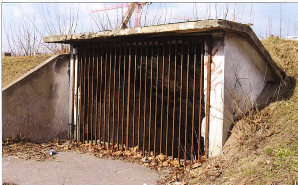
Żelbetowe zadaszenie przejścia podziemnego po zewnętrznej stronie toru, widok od strony południowo-wschodniej. (fot. Jakub Andrzejewski, 2020 r.)
