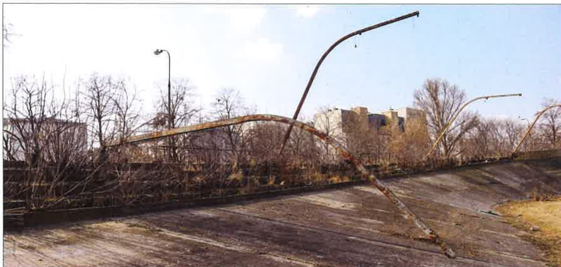
Uszkodzony przez podcięcie słup oświetleniowy, leżący na fragmencie toru jezdnego po południowo-zachodniej stronie obiektu. (fot. Jakub Andrzejewski, 2020 r.)
