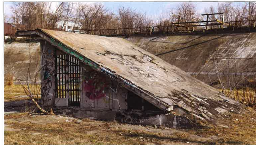
Żelbetowe zadaszenie przejścia podziemnego po wewnętrznej stronie toru, widok od strony południowej. (fot. Jakub Andrzejewski, 2020 r.)
