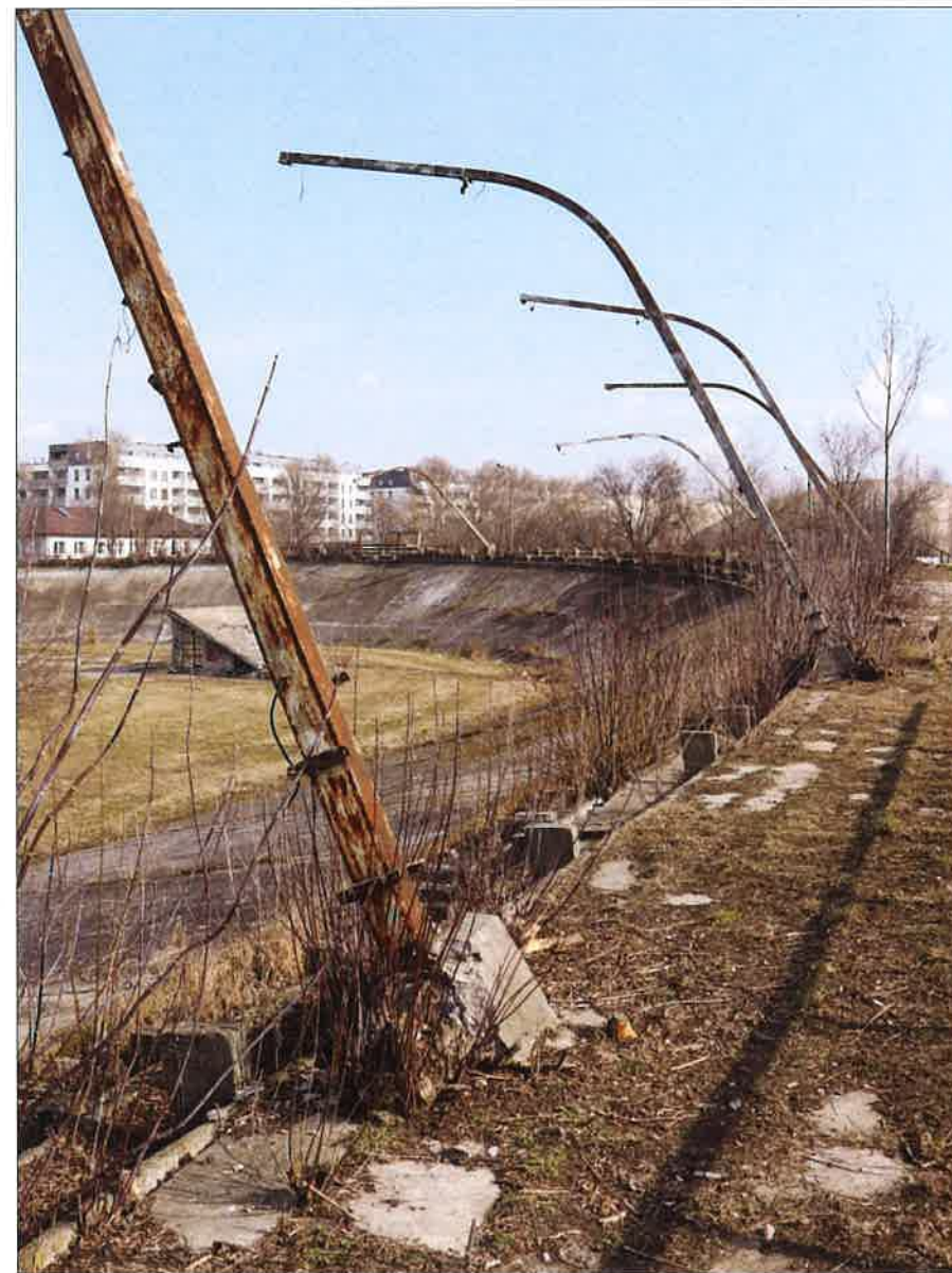
Uszkodzone lampy do oświetlania toru posadwione na szczycie nasypu po stronie południowej. (fot. Jakub Andrzejewski, 2020 r.)
