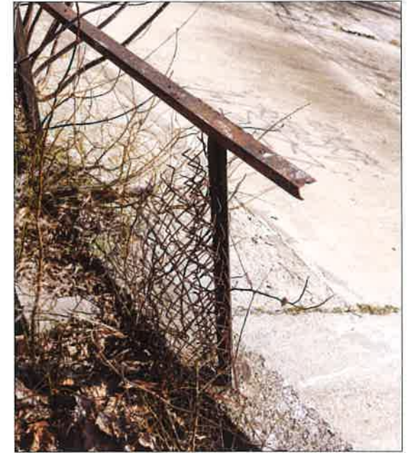
Fragment zniszczonej barierki po stronie południowo-zachodniej. (fot. Jakub Andrzejewski, 2020 r.)
