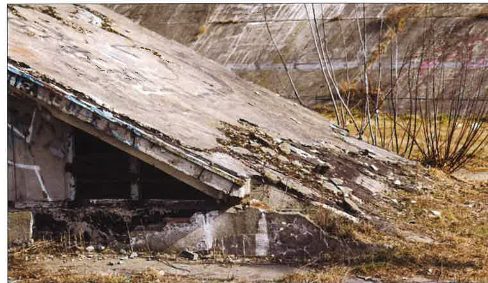
Żelbetowe zadaszenie przejścia podziemnego na połączeniu z gruntem, widoczne uszkodzenia warstw pokrycia dachowego. (fot. Jakub Andrzejewski, 2020 r.)
